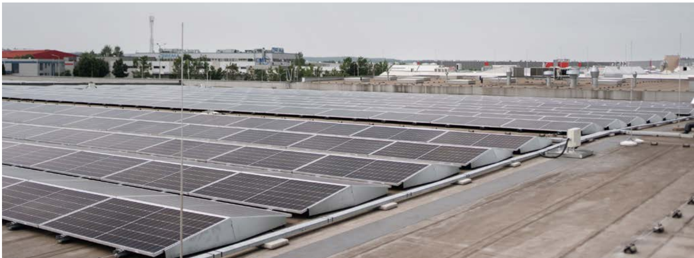
Do výstavby fotovoltaické elektrárny na střeše chlazeného skladu v Modleticích bylo investováno 19 milionů korun. Pokrýt by měla 22 % spotřeby skladu. Úspora CO 2 je 572 tun ročně, finanční úspora je přibližně 4,5 milionu korun za rok.
