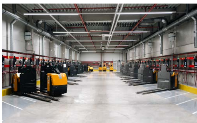
Nabíjecí stanice elektrických vozíků
