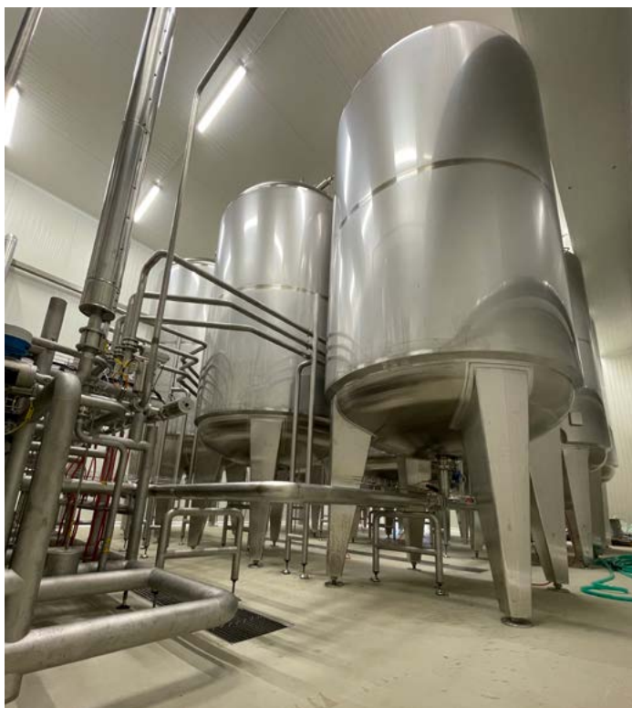
Zásobní tanky na ready-to-fill nápoje
